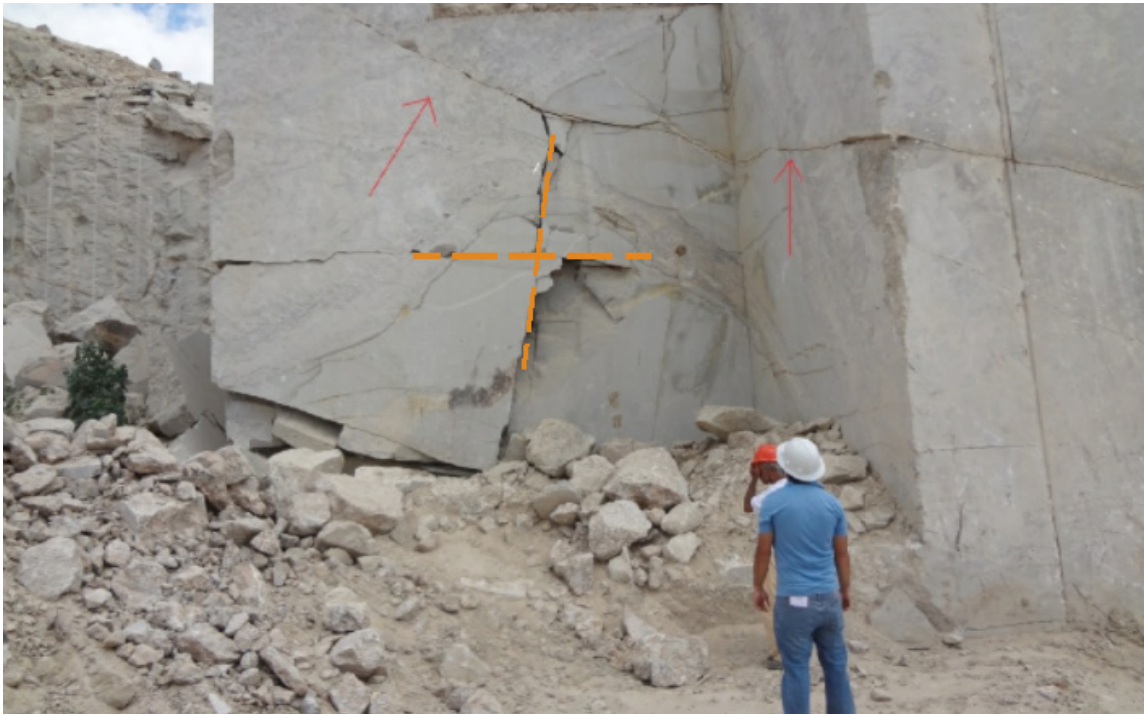
Figura 9. Indicação de fraturas de cisalhamento tipo Riedel.
