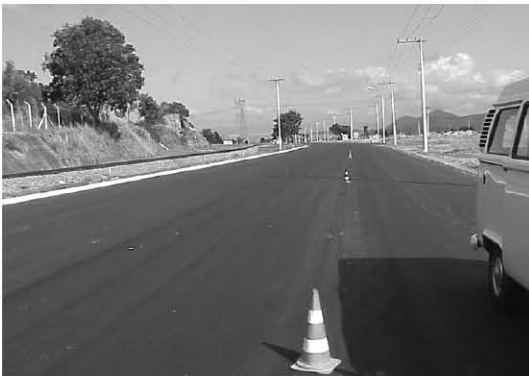
Figura 10. Base e sub-base construídos com acerita (TIMS – Terminal Industrial Multimodal da Serra – ES)
