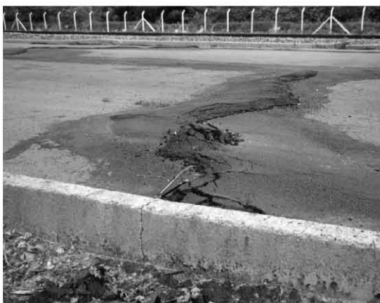
Figura 1. Revestimento de asfalto rompido por expansão da Escória de aciaria LD
