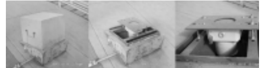
Figura 3. Fotos das montagens dos sensores no teto do gasômetro.
