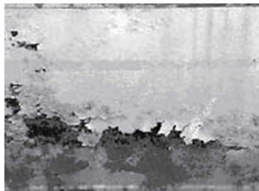
Figura 11. Destacamento da pintura e ataque corrosivo no material da Ponte Marechal Hermes.
