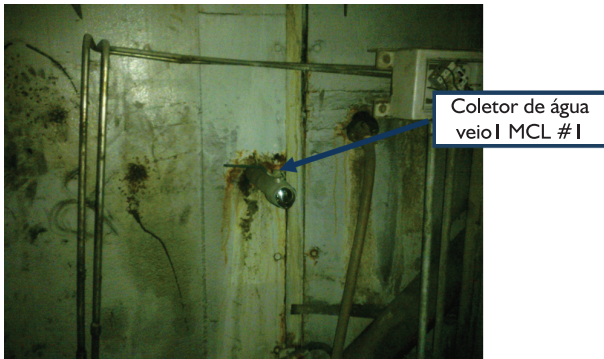
Figura 3. Coletor de água do veio I da MCL #1.
